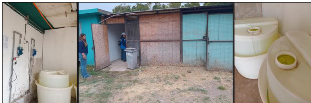
Imagen N° 27: Sala de cloración en planta ESSSI Padre Hurtado.
