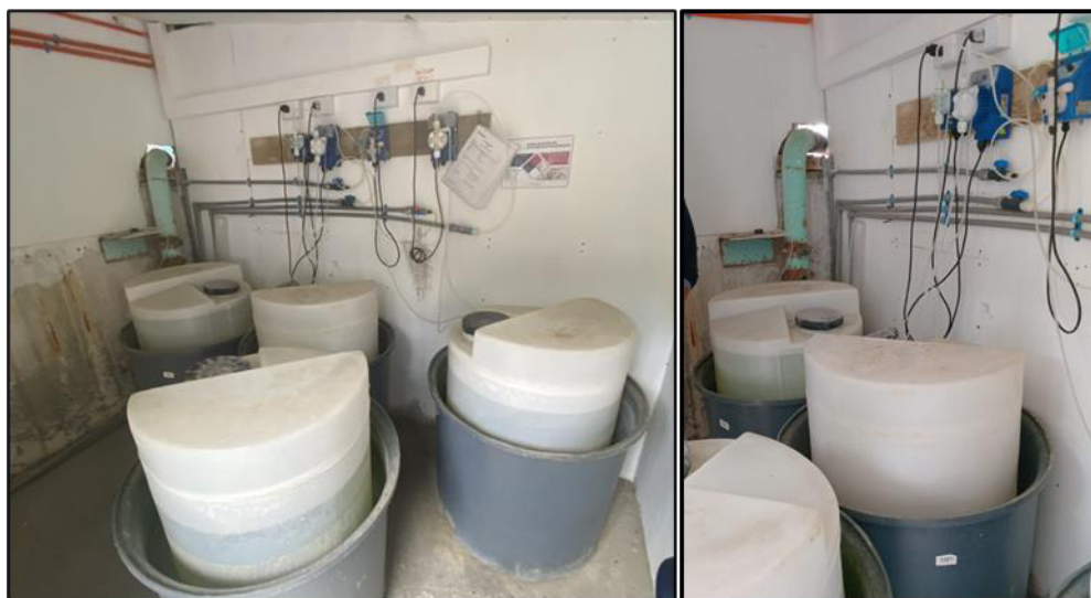
Imagen N° 26: Sala de cloración de la planta ESSSI Pillanlelún.
