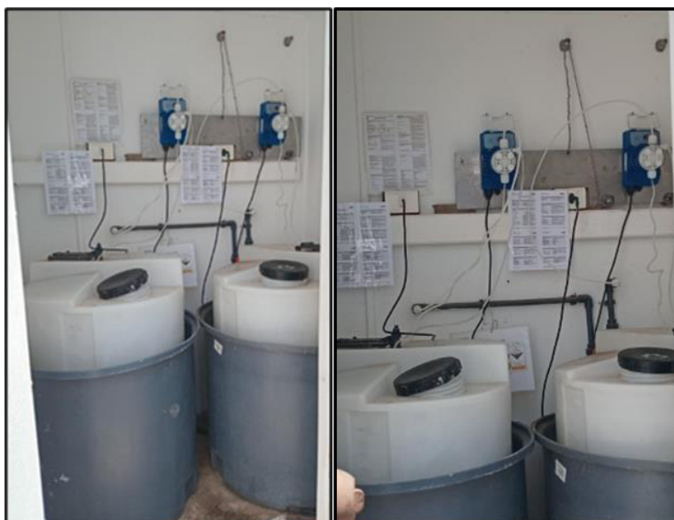
Imagen N° 28: Sala de cloración en planta ESSSI Altos de Cantillana.
